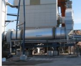
Torktrumma på asfaltsverk.
